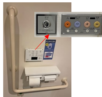
水を流す操作パネルが見えない
