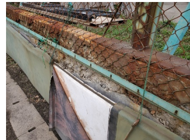
劣化が進むコンクリートの土台部分
