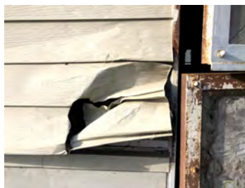
厩舎の壊れた外壁
