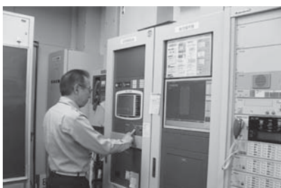
防災監視盤操作状況
