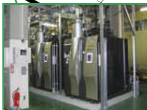
⑤ 省エネ型設備等への更新 【ボイラー設備等】
