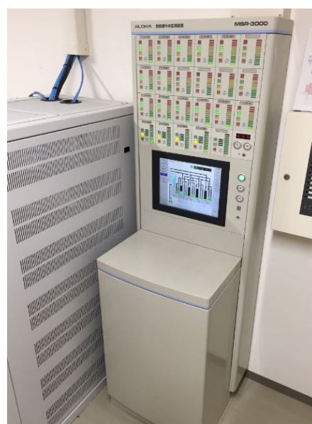
放射線中央監視装置
