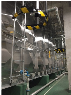
排水設備（北棟地下2階）
