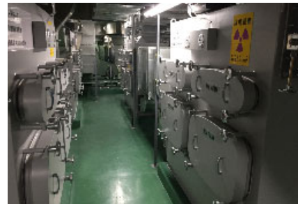
排気設備（南棟6階）
